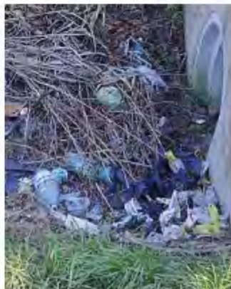
Un canale di scolo intasato
