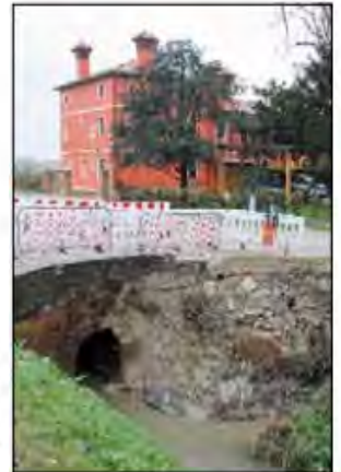
Il ponte chiuso in via Foscara
