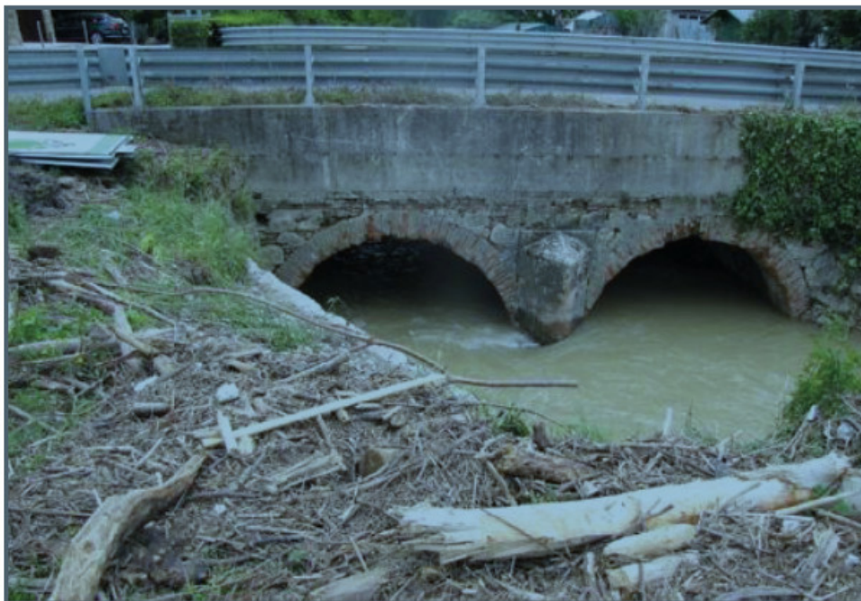
Il ponte sulla strada regionale 11 che si è subito intasato innescando l'esondazione
