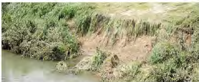
Una delle frane sull'argine sinistro del Tesinella
