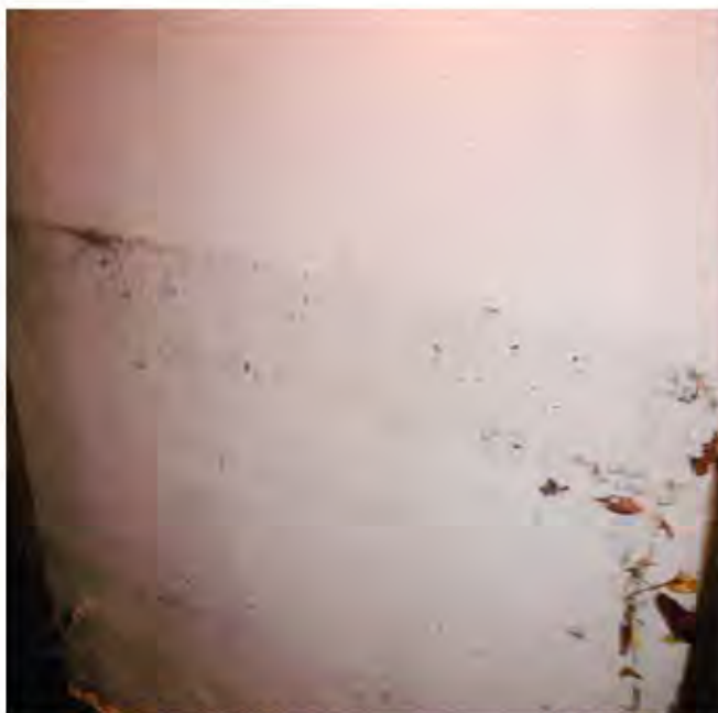
Il segno di dove è arrivata l'acqua
