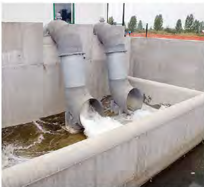
L'impianto Idrovoro inaugurato ieri alla Gazzera
