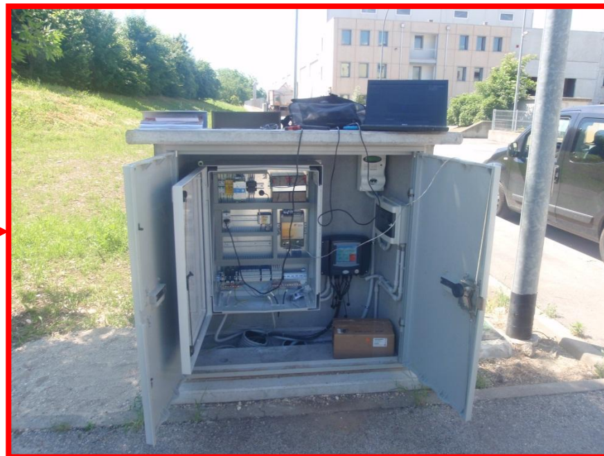
QUADRO DI CONTROLLO
