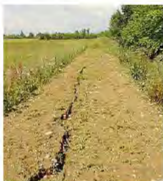
Crepa nell'argine destro
