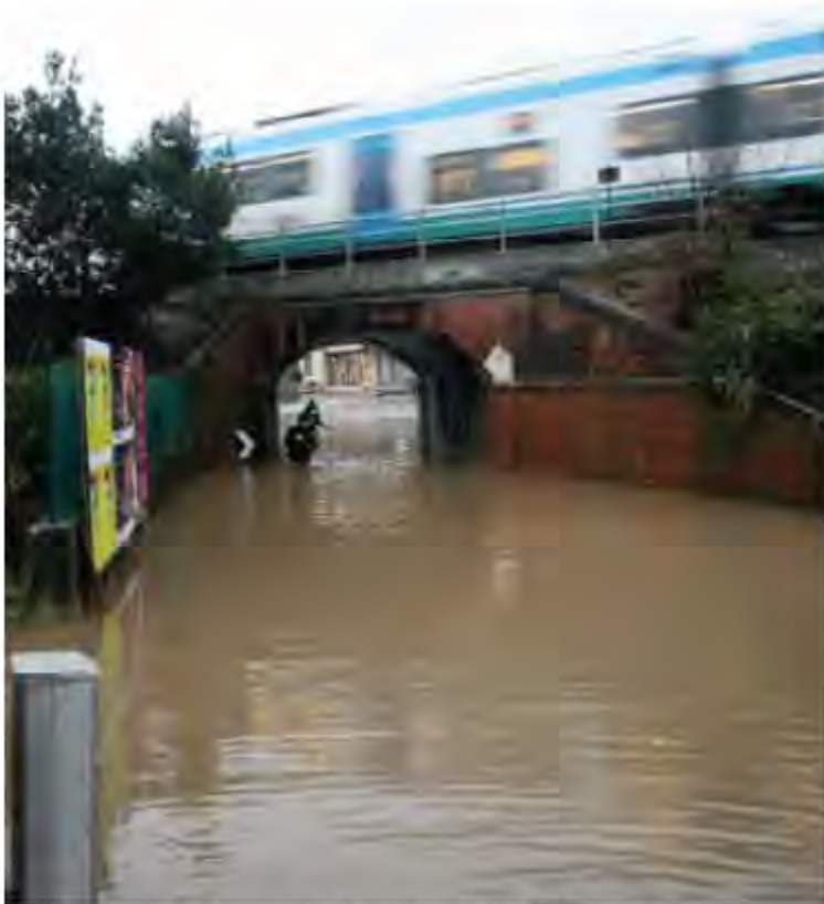
Il sottopasso di Rozzampia durante uno degli allagamenti
