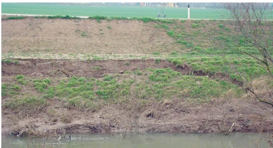
Lo smottamento dell'argine del Bacchiglione dopo via Giotto a Roncajette
