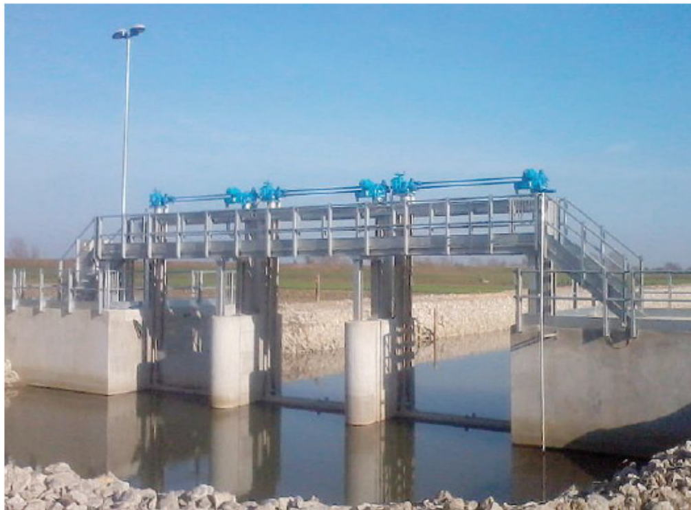
Il manufatto idraulico di sostegno delle acque lungo lo scolo Altipiano a Codevigo in località Muneghe
