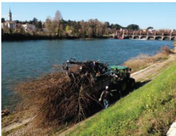
La pulizia degli argini dell'Adige nel tratto fra ponte Catena e la Diga
