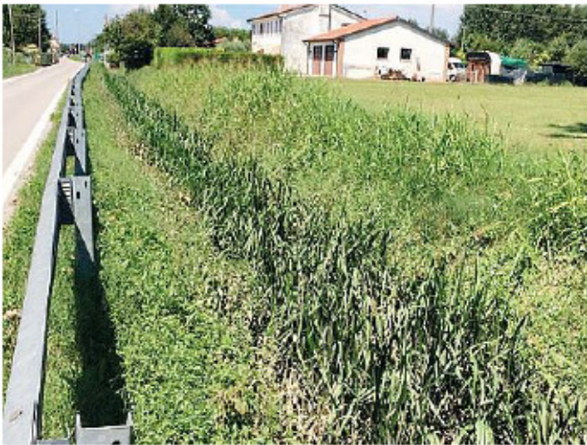
L'erba alta nei fossati impedisce all'acqua di scorrere
