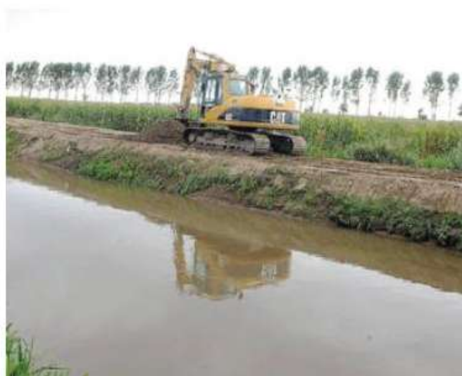
I lavori di un consorzio di bonifica lungo un corso d'acqua. ARCHIVIO
