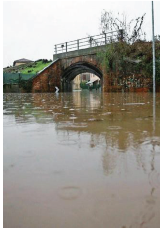
Il sottopasso ferroviario di Rozzampia completamente allagato
