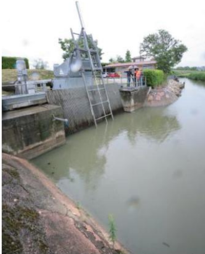
L'impianto delle idrovore in via Ponte del Quarelo. FOTO COLORFOTO
