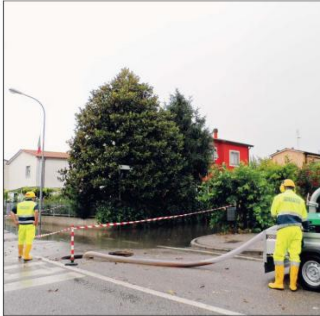
Un intervento della protezione civile per gli allagamenti giugno
