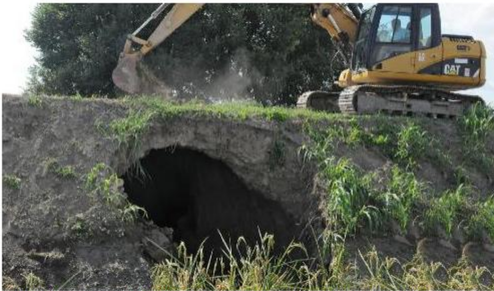
L'enorme tunnel scavato dalle nutrie a Vangadizza in via Bragadina lungo il Bussé DIENNE FOTO
