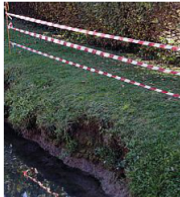
Il tratto crollato dell'argine
