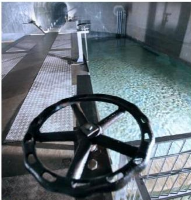
Al Centro idrico di Novoledo si misura il livello della falda
