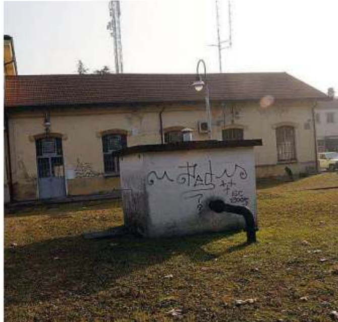
Uno dei pozzi dell'acquedotto di via Lancieri di Novara a Treviso
