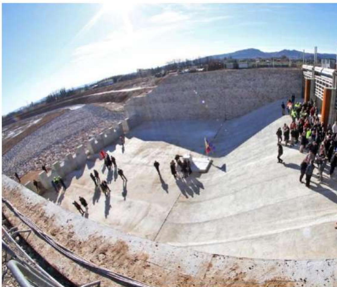
L'opera di presa della prima vasca del bacino di laminazione di Caldogno inaugurata ieri. FOTO CISCATO
