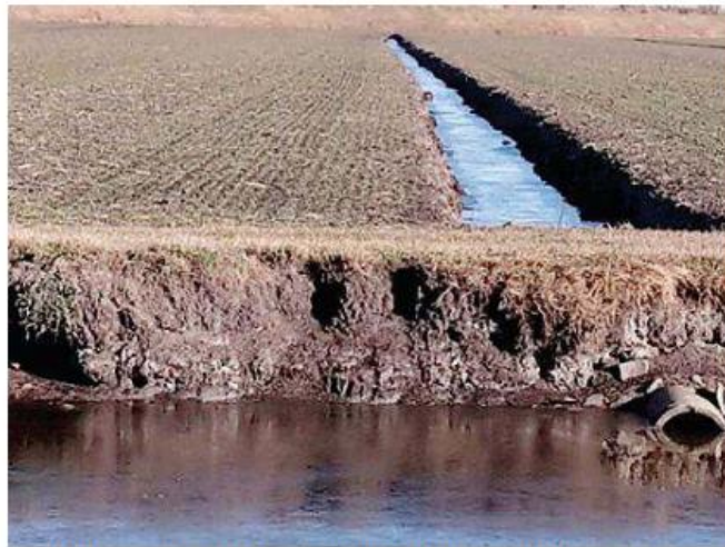
Un argine perforato dalle tane delle nutrie ed eroso dalle microfrane
