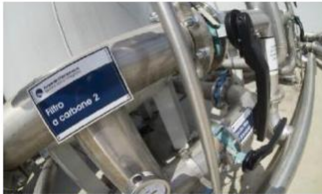
Un impianto di filtraggio con carboni attivi di Acque del Chiampo
