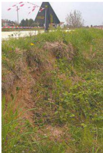
La frana sull'argine
