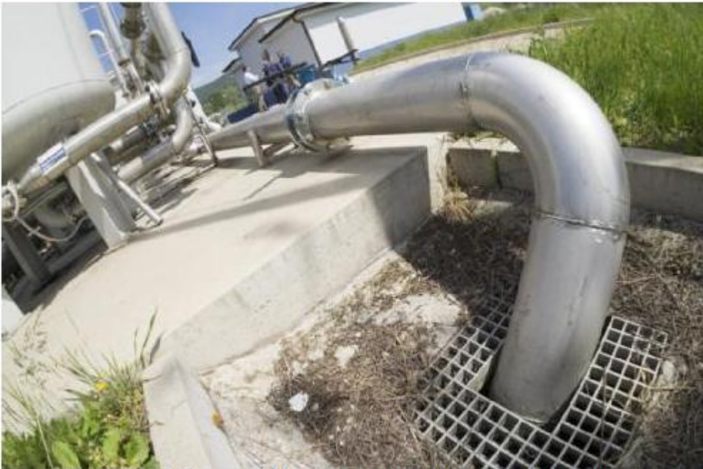
Impianto di depurazione delle acque nel Vicentino, la provincia dove la minaccia Pfas è più consistente
