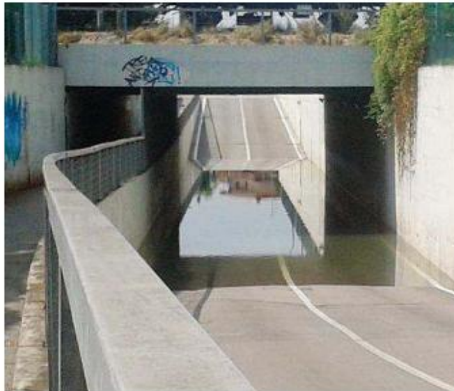
Il sottopasso di via Sarpi allagato dopo la pioggia
