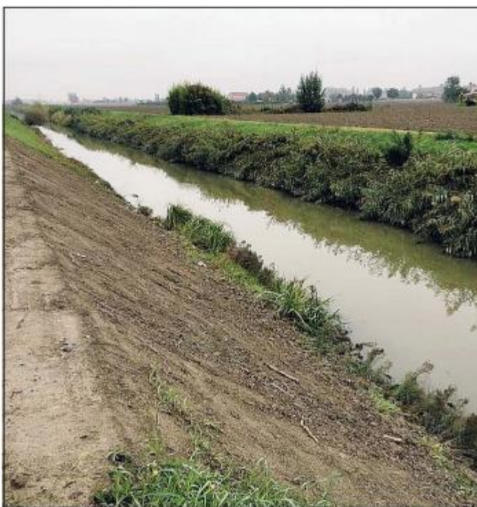
Problema risolto, quello dei cedimenti arginali
