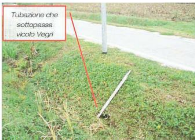
Criticità in via Vegri evidenziata nello studio sui fossati
