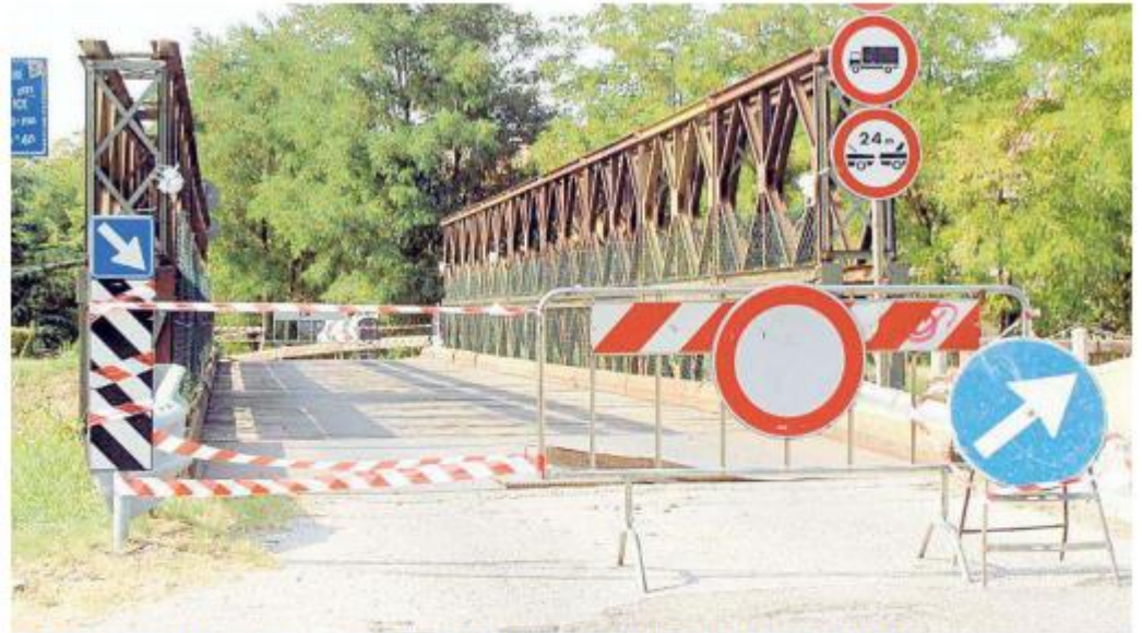
Un ponte chiuso al traffico per problemi di sicurezza: a Caerano divieto sul ponte Ca' Mula
