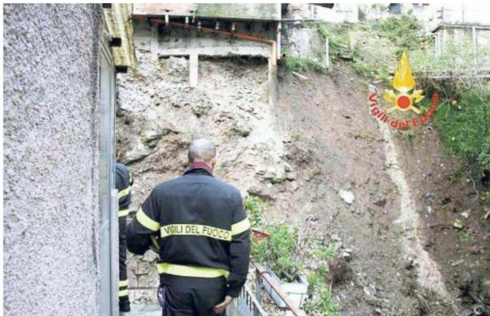
Nella foto dei Vigili del fuoco le fondamenta di uno dei palazzi sgomberati a Genova, messe a nudo dalla frana
