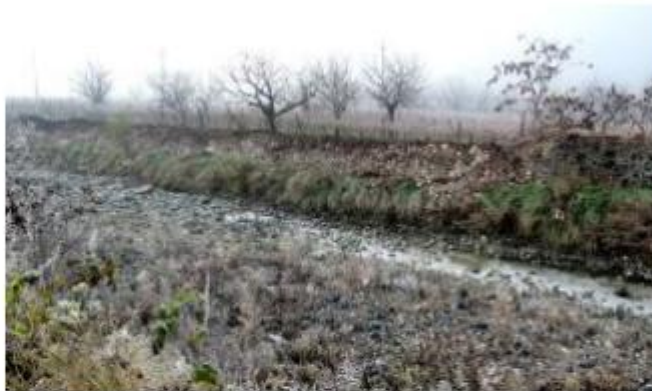
Il muro di contenimento dell'Alpone crollato FOTO AMATO
