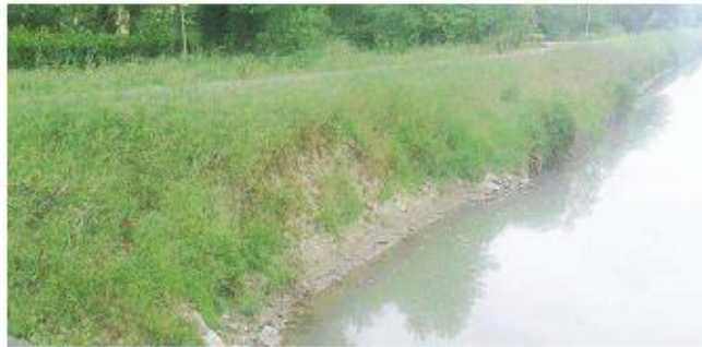
Crolli delle rive lungo il canale Serraglio
