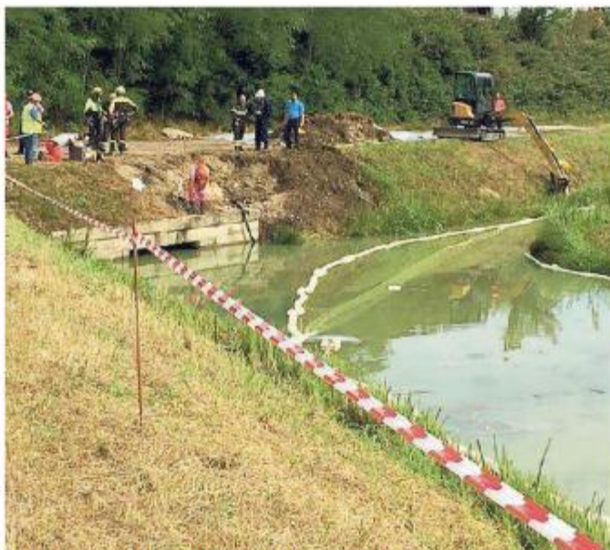
Vigili del fuoco e tecnici cercano di arginare lo sversamento di gasolio
