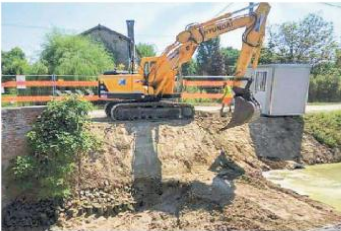
La ruspa in azione: è stata danneggiata per un cortocircuito ieri notte
