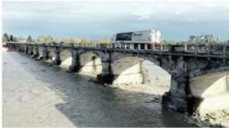
IL PONTE sul Piave necessita lavori di ristrutturazione
