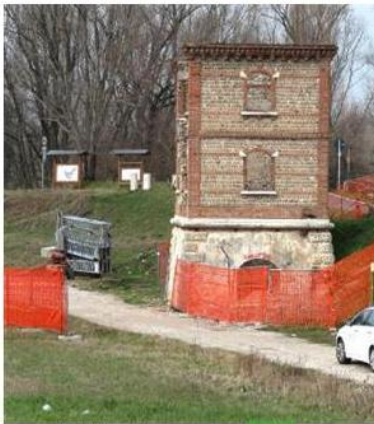
Casa Bombardà: lavori fermi in attesa della bonifica. FOTO ALBERTO
