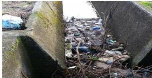
Rifiuti accumulati negli scoli autostradali possono creare intasamenti e anche allagamenti.
