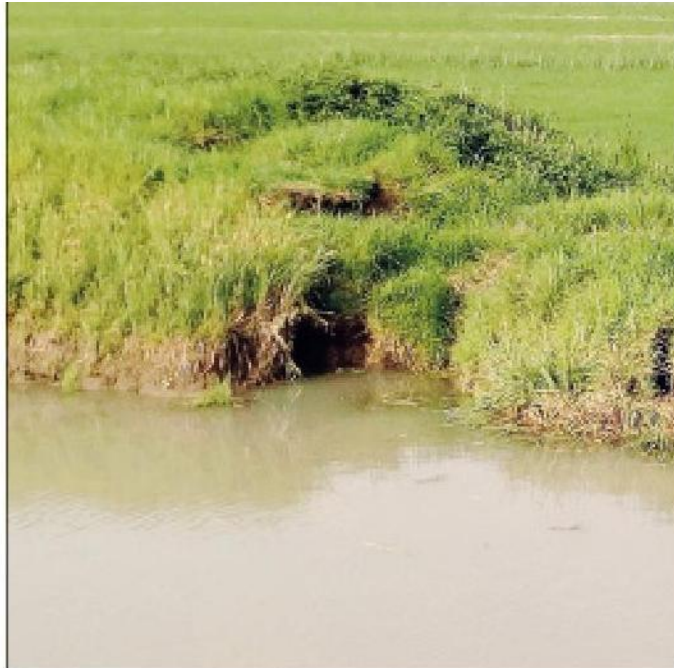
Il cedimento a causa delle tane nel canale Giarette
