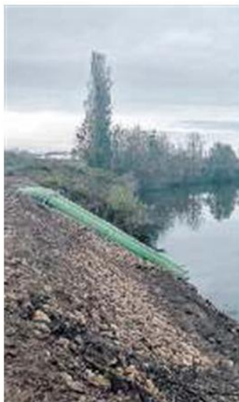
IDROVORA La pompa inaugurata nel febbraio scorso
