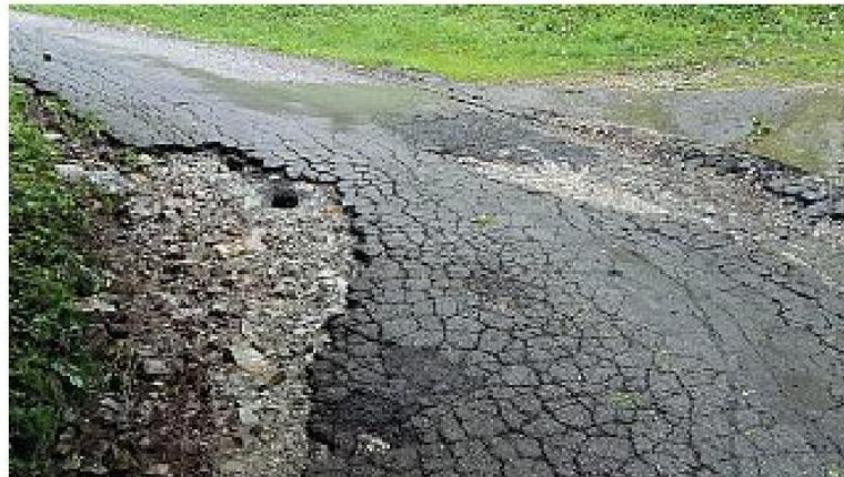
Asfalto dissestato I danni sulle strade provocati dall'acqua nei comuni colpiti dal maltempo
