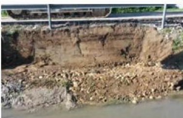
L'argine eroso è stato oggetto dell'intervento del consorzio
