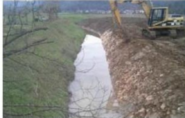
Il tratto del torrente Onte interessato dalle frane delle sponde
