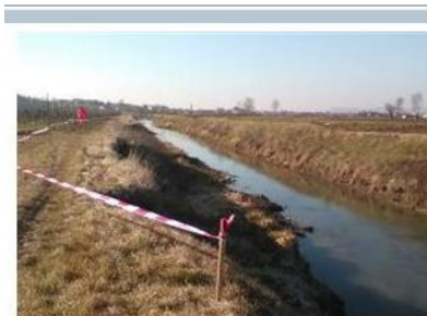
Il punto dove ha ceduto l'argine qualche giorno fa. BERTOZZO
