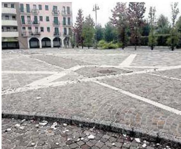
DEGRADO Da anni la piazza versa in condizioni inaccettabili
