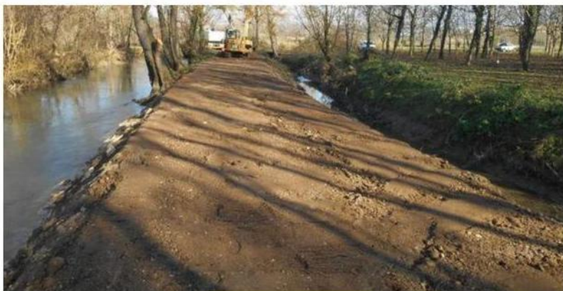
Un tratto dell'argine del Fibbio durante i lavori del Consorzio di bonifica Alta pianura veneta
