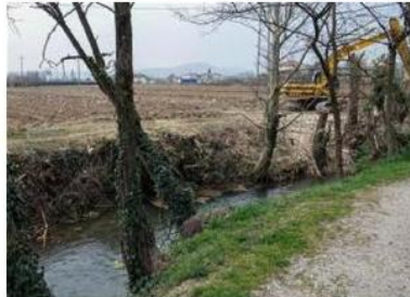
I lavori in corso sull'argine della roggia in via Pisacane. FOTO CASANOVA
