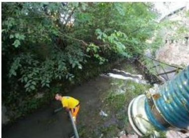
Al lavoro per cercare di liberare i canali dal gasolio
