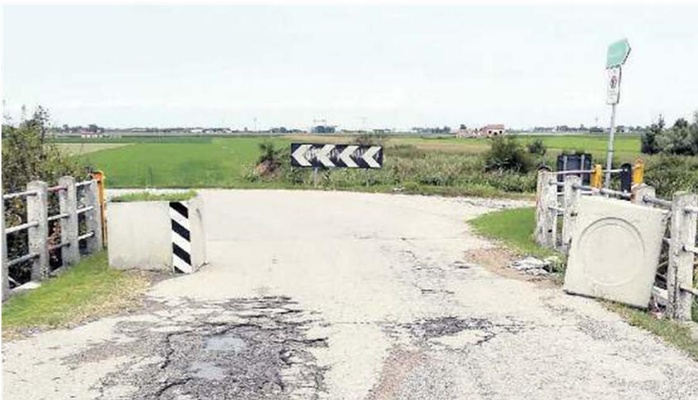
PORTO VIRO Sul ponte Gramignara da tempo vigeva il limite di transito, ora non si passerà più per la pericolosità
