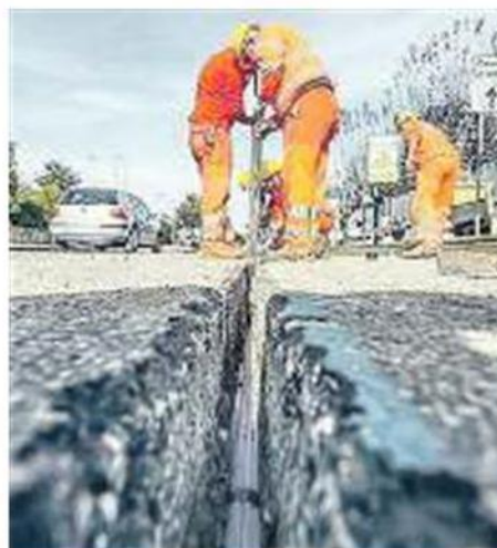
LAVORI IN CORSO La posa della fibra ottica attuata da Open Fiber
