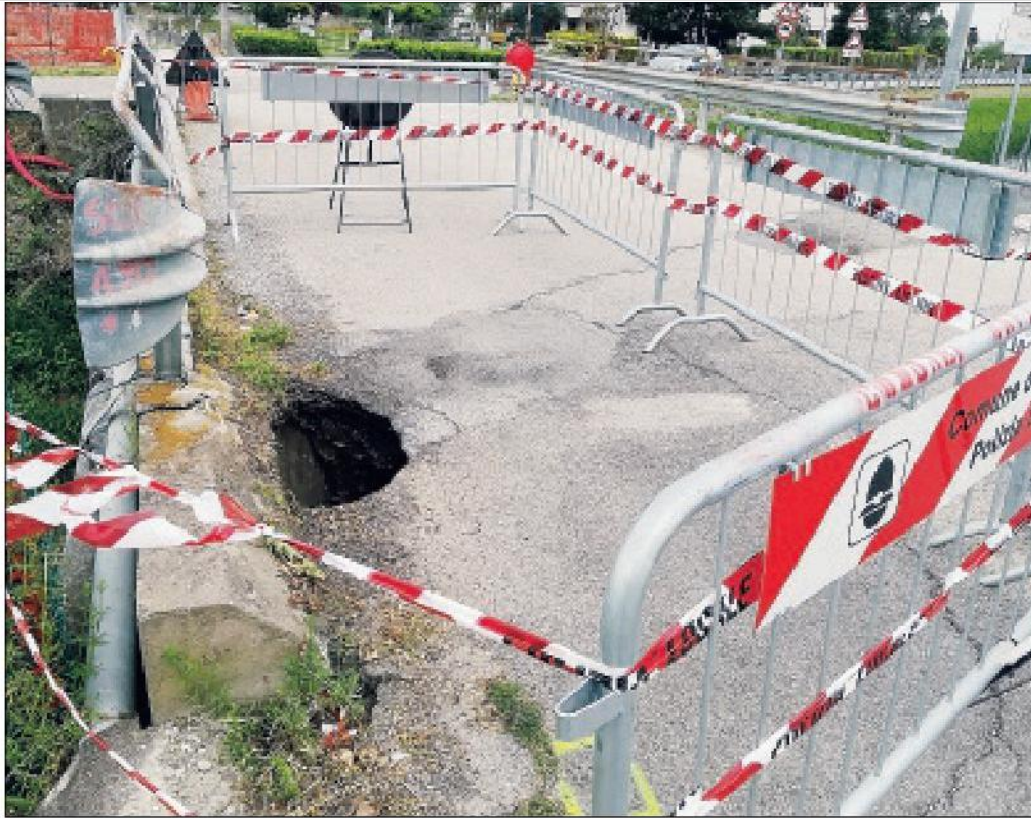
Un ponte danneggiato lungo la rete stradale polesana (foto d'archivio)
